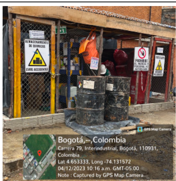
Foto No. 10 Área de almacenamiento de residuos peligrosos
